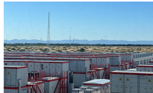
山东磴口 500MWh 储能项目
