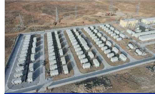
阿拉善 180MWh 液冷项目
