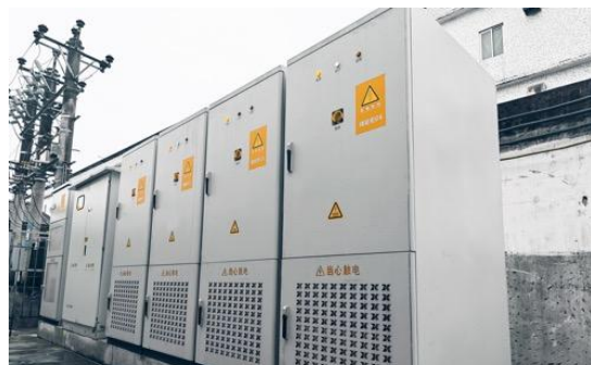
广东揭阳2MWH风冷工商储项目
