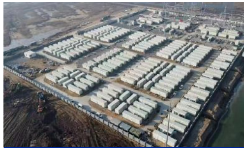
山东东营 260MWh储能项目
