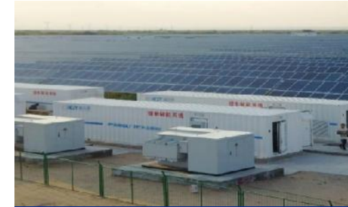
西藏 200MWh 光伏储能项目
