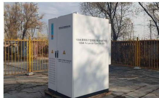
中石油2MWH风冷钠电池工商储
