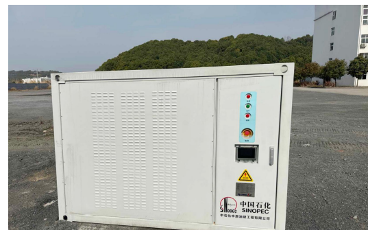
恒达户外储能项目
