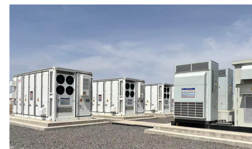
金塔 360MWh 储能项目
