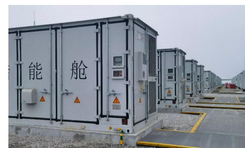
内蒙古 400MWh 液冷储能项目
