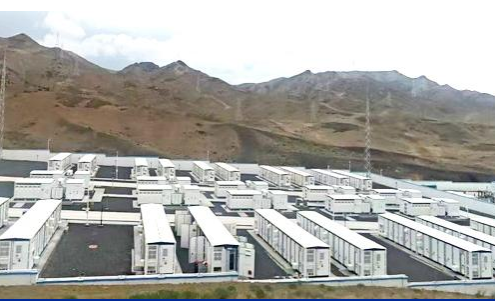
乌鲁木齐 200MWh 储能项目
