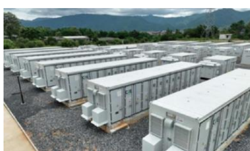
湖南江华 400MWh项目
