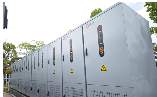
绿沃233KWH液冷储能一体柜项目
