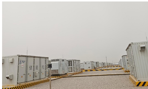
新疆 1GWh 液冷储能项目
