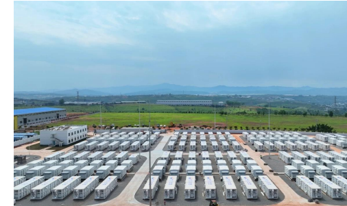
云南 600MWh 液冷储能项目
