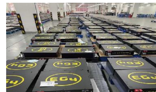
低压家储5KWH项目
